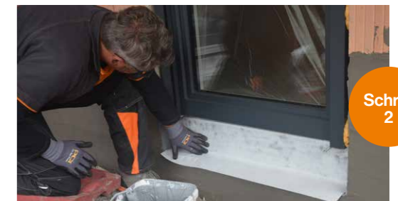
Das PCI Barraseal Ready Vlies vollflächig in die noch frische Schicht PCI Barraseal Ready einlegen und vorsichtig andrücken.*
