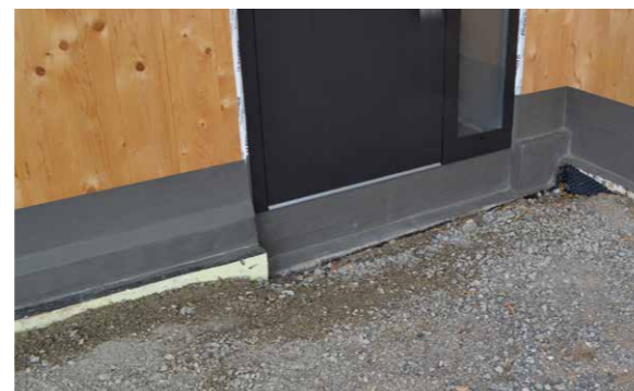
Anarbeiten der flexiblen mineralischen Dichtschlämme PCI Barraseal Turbo an das Dichtband und Fensterelement
